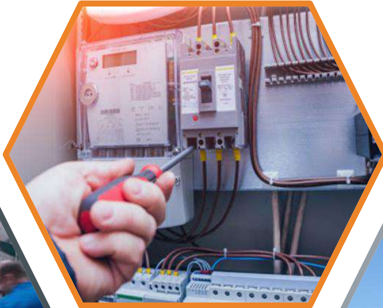
Les systèmes électriques et électroniques
